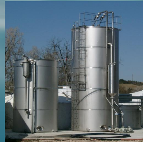
Jet-Loop System – Dois Portos., Torres Vedras, by Tecnia, Lda 2002-2003
